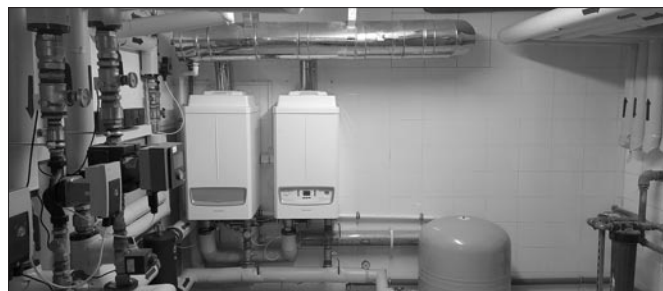
Zmodernizowana kotłownia w szkole w Olszówce
